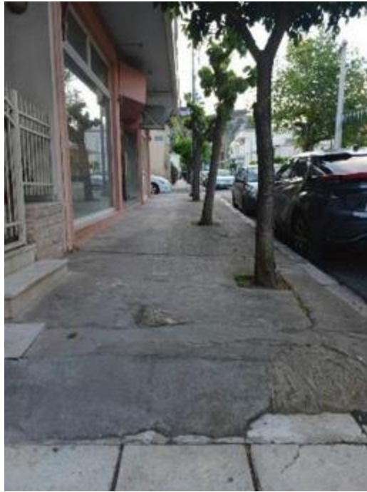
Εικόνα 34: Κατάσταση πεζοδρομίου οδού Λεωφόρος Σαλώνων.
