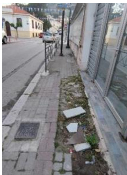
Εικόνα 24:Σπασμένες πλάκες στο πεζοδρόμιο της οδού Γιδογιάννου.
