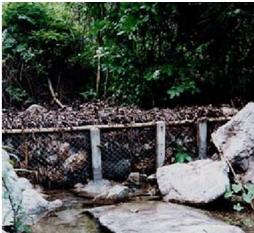
Εικόνα 9: Φράγμα συγκράτησης φερτών
