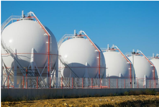
Fig. 1: LNG Storage Tanks
