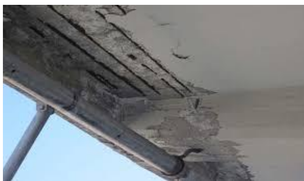
Σχήμα 1.1 Διάβρωση οπλισμού (Κουρνέτας 2010)
