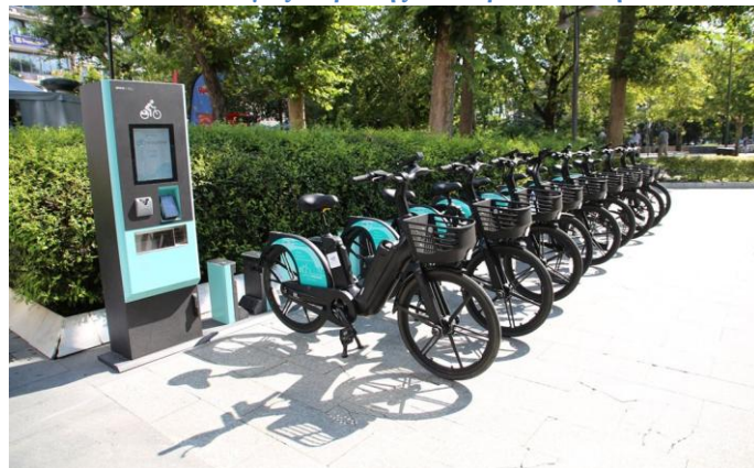
Εικόνα 15: Σταθμός Φόρτισης Ηλεκτρικών Ποδηλάτων
