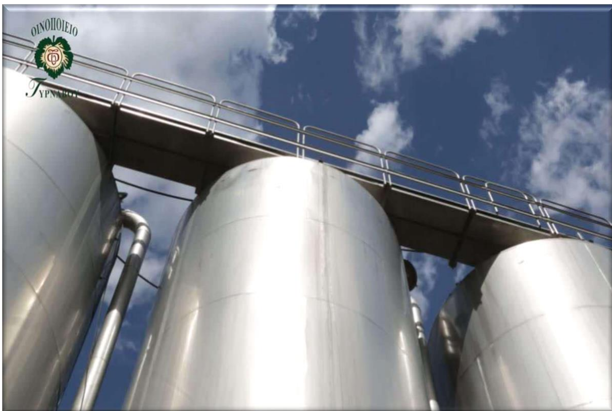
Εικόνα 54. Ανοξείδωτες Δεξαμενές Αποθήκευσης Οίνου.
