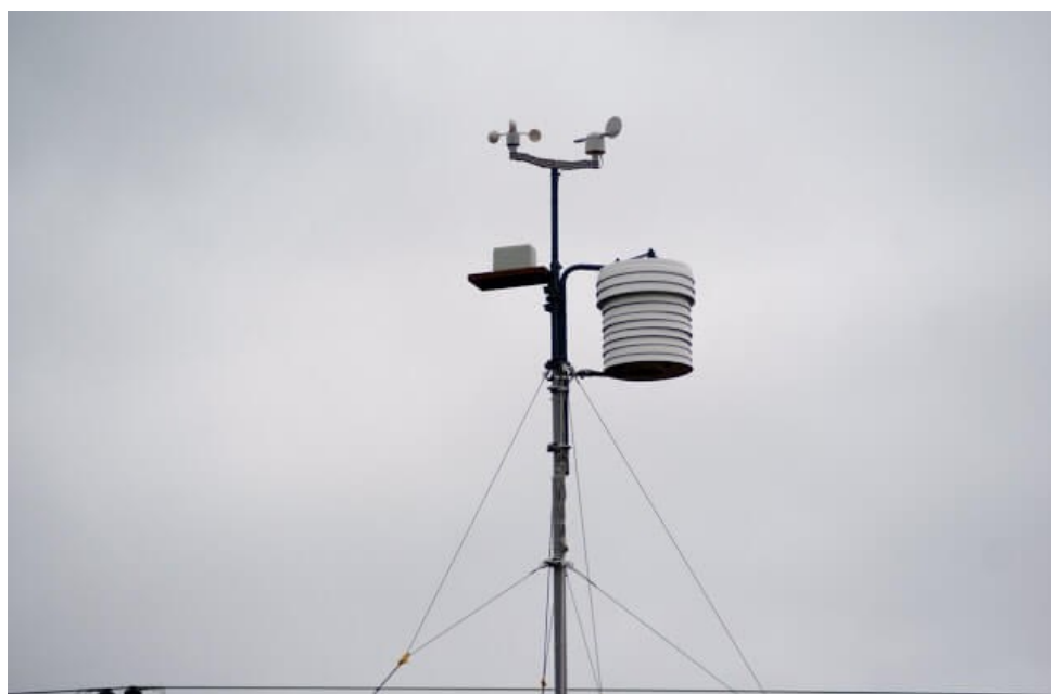
Εικόνα 7 Μετεωρολογικός σταθμός με βροχόμετρο (Ιστός Μετεωρολογικού σταθμού Οινόφυτων, χ.χ.)
