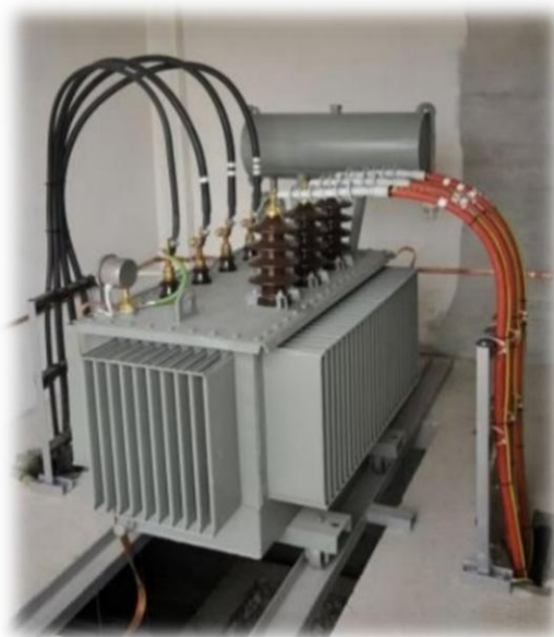
Σχήμα 1.3.: Μετασχηματιστής υποβιβασμού τάσης, MT/XT.
