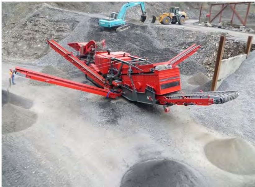
Εικόνα 3.5.: Σπαστήρας και μεταφορικές ταινίες
