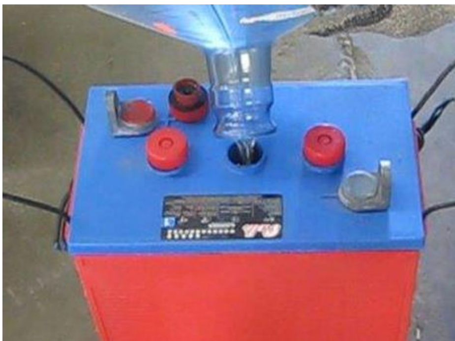
Εικόνα 9: Συμπλήρωση νερού σε ένα συσσωρευτή υγρού ηλεκτρολύτη
