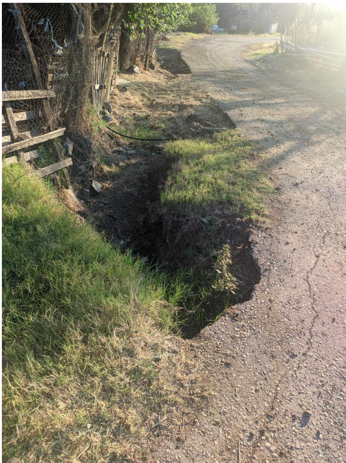
Εικόνα 8. Καταστροφές από τον Ιανό
