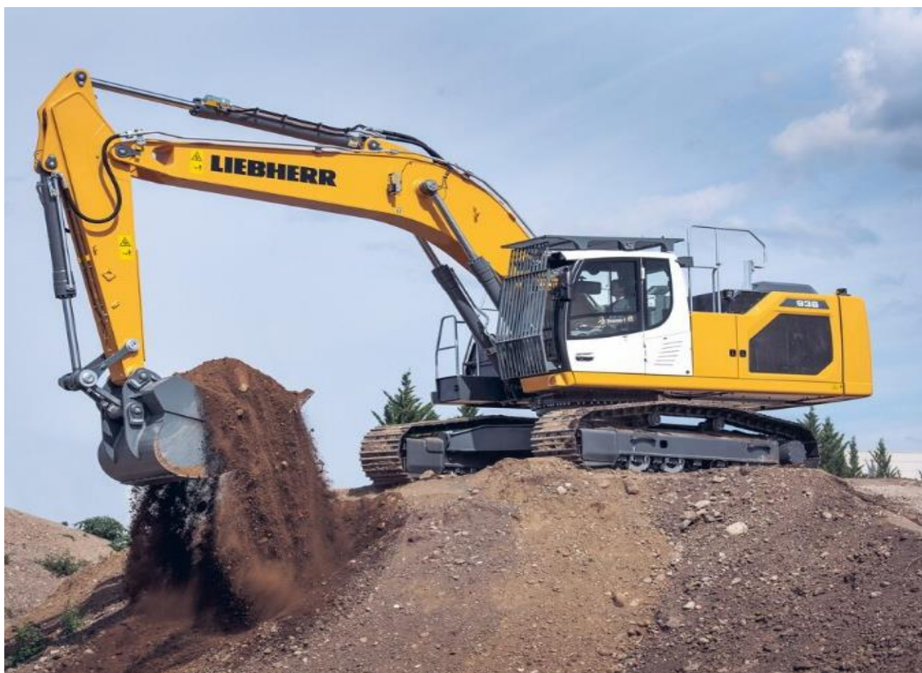
Εικόνα 8.: Ερπυστριοφόρος Εκσκαφέας R-938.
