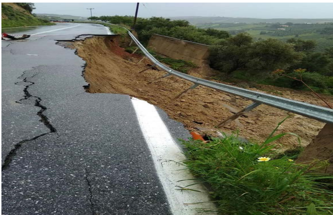
Εικόνα 4 Καθίζηση δρόμου (Πηγή: https://www.patrasevents.gr )
