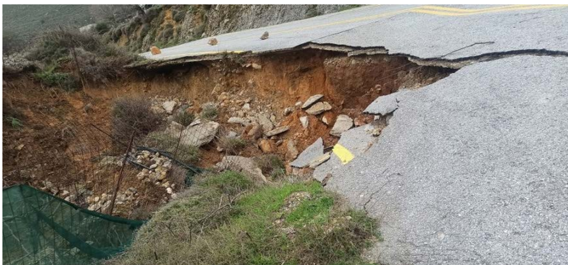
Εικόνα 3 Υποχώρηση δρόμου (Πηγή: https://www.protothema.gr )
