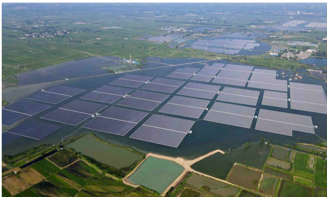
Εικόνα 24 - Πλωτό φωτοβολταϊκό πάρκο στην Huainan
