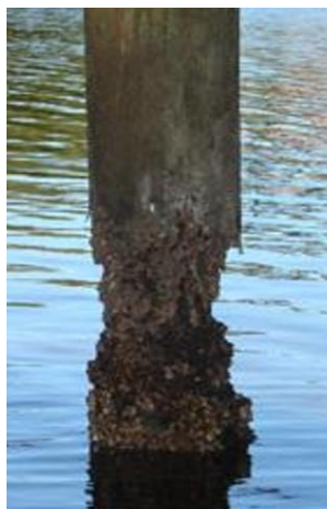
Εικόνα 2.6: Προσβολή υποστήριγμα αποβάθρας από θαλάσσιους μικροοργανισμούς
