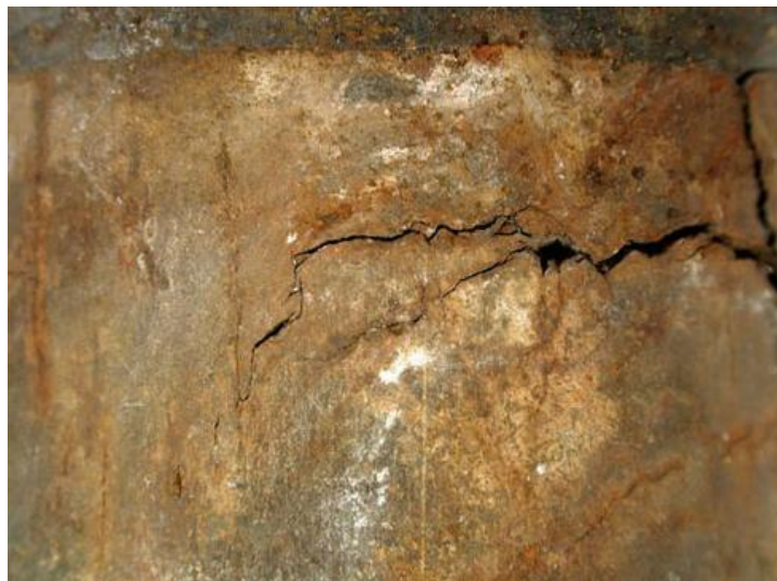
Εικόνα 18: Ρωγμή διάβρωσης υπό μηχανική τάση [54]
