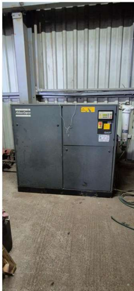
Εικόνα 3.8: Αεροσυμπιεστής Atlas Copco GA37
