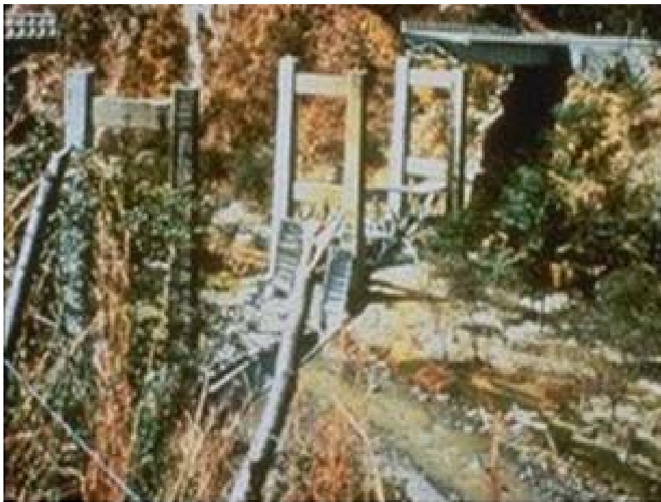
Σχήμα 1.5 Κατάρρευση τριών ανοιγμάτων της γέφυρας Agua Caliente, κοντινή λήψη
