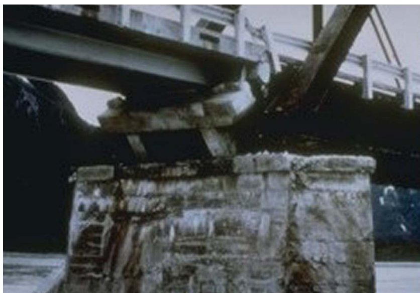
Σχήμα 1.3 Ζημιά στη στήριξη της γέφυρας Copper River λόγω ταλάντωσης
