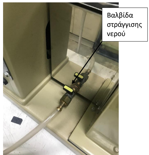
Εικόνα 3.6: Η βαλβίδα απ' όπου στραγγίζεται η δεξαμενή πλήρωσης
