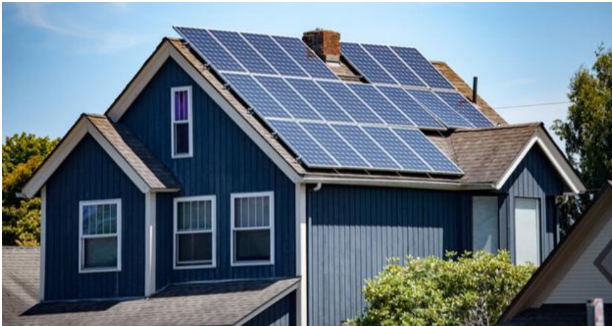
Εικόνα 4.1.6: Φωτοβολταϊκό σύστημα σε στέγη.
