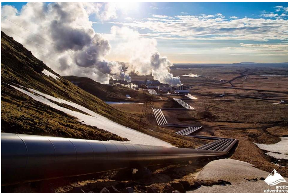
Εικόνα 7.4.3: Γεωθερμικός σταθμός Hellisheiði στο Χέινκιλ, Ισλανδία.
