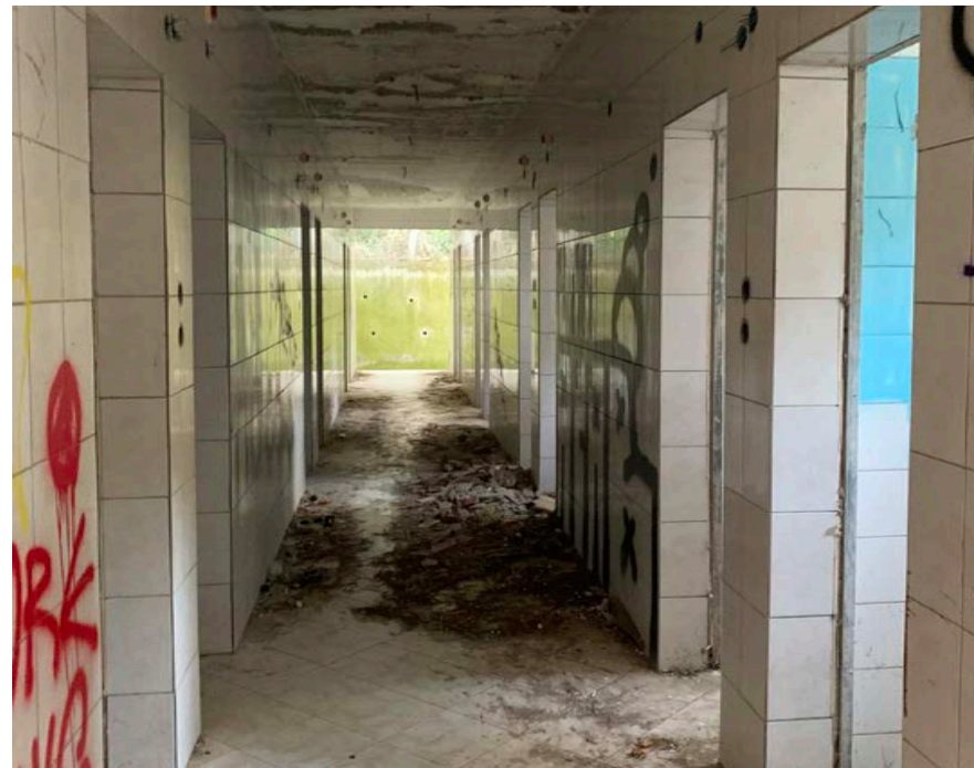
Εικόνα 20: Φωτογραφία Εσωτερικού Χώρου Ιδιωτικών Λουτρών
