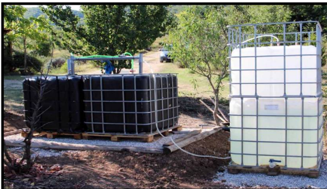
Εικόνα 18 β) Μονάδα βιοαερίου http://skalaecovillage.com/el/gallery
