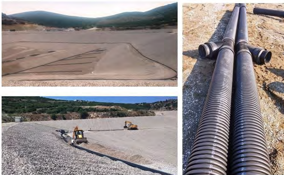
Εικόνα 36 Στρώση και αγωγοί αποστράγγισης.
