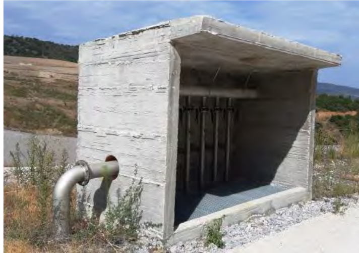
Εικόνα 26 Φρεάτιο συλλογής και έλεγχου βιοαερίου 23
