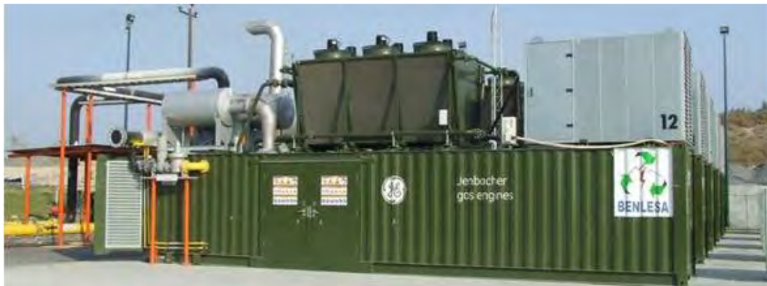
Εικόνα 32 Μονάδα ενεργειακής αξιοποίησης βιοαερίου 27
