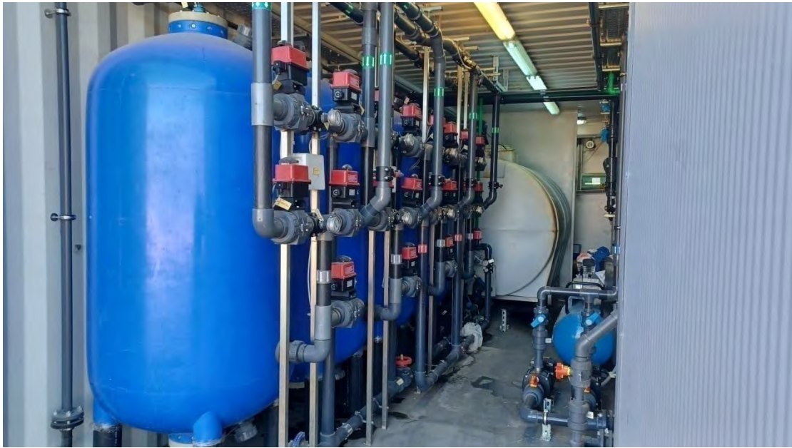
Εικόνα 64 Τέσσερα αμμόφιλτρα σε σειρά – Δεξαμενή ( άσπρη ) ακατέργαστου .
