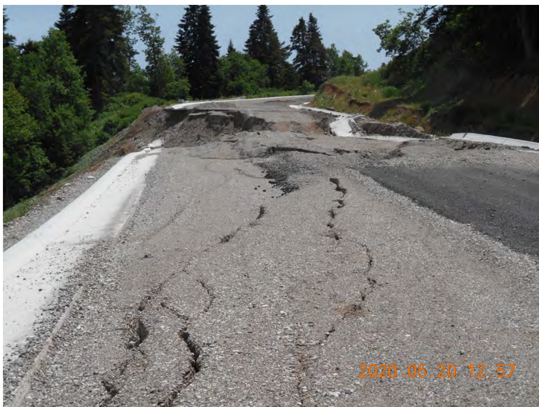
Φωτ. 26: Ανοικτές ρωγμές.
