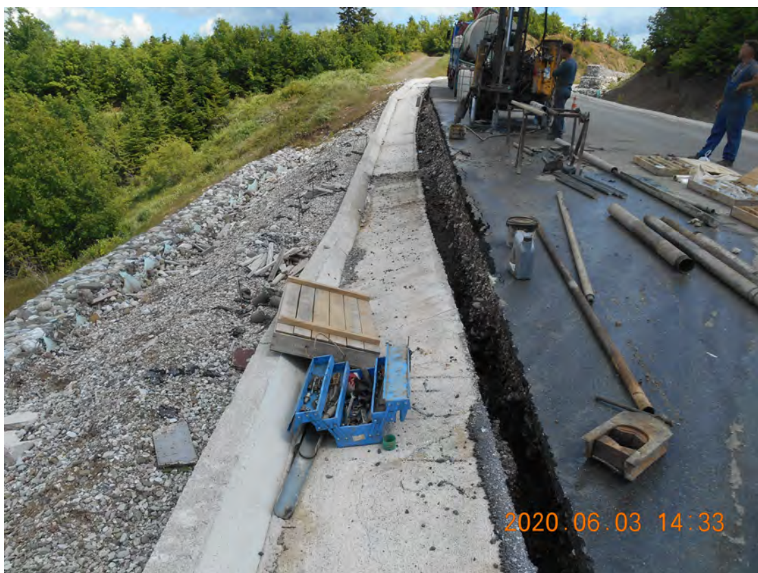
Φωτ. 28: Άποψη αστοχίας επιχώματος και συρματοκιβωτίων.
