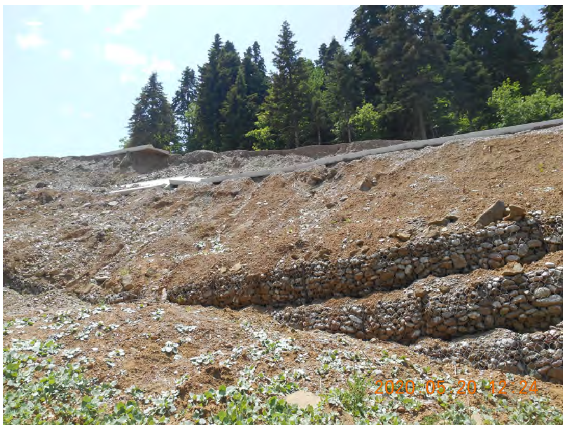
Φωτ. 22: Άποψη αστοχίας επιχώματος και συρματοκιβωτίων.
