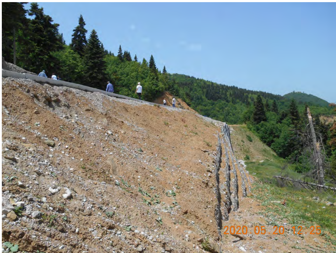
Φωτ. 23: Άποψη αστοχίας επιχώματος.
