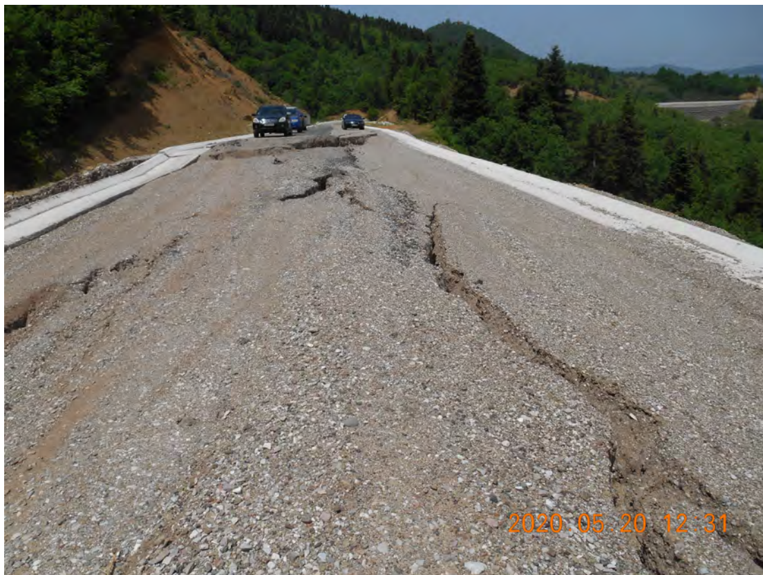
Φωτ. 25: Ανοικτές ρωγμές.
