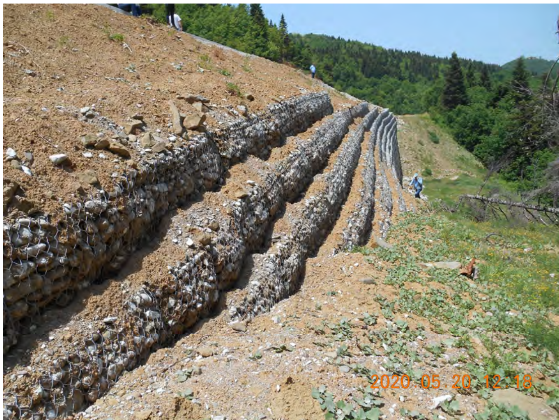
Φωτ. 20: Άποψη αστοχίας επιχώματος, με μεγάλες παραμορφώσεις στα συρματοκιβώτια.
