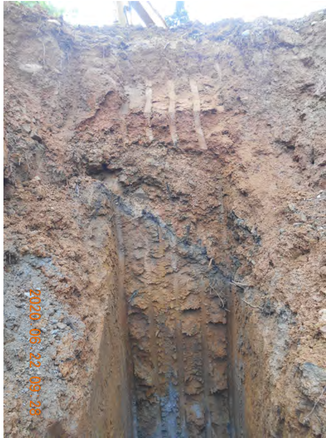
Φωτ. 15: Φρέαρ Φ2, από το βάθος των 0,00 έως 3,00 m, στα πλαίσια της Γεωτεχνικής Έρευνας - Μελέτης αποκατάστασης αστοχίας δύο επιχωμάτων στη Χ.Θ. 2+030 & 2+800 στο έργο: Παράκαμψη Νεοχωρίου.
