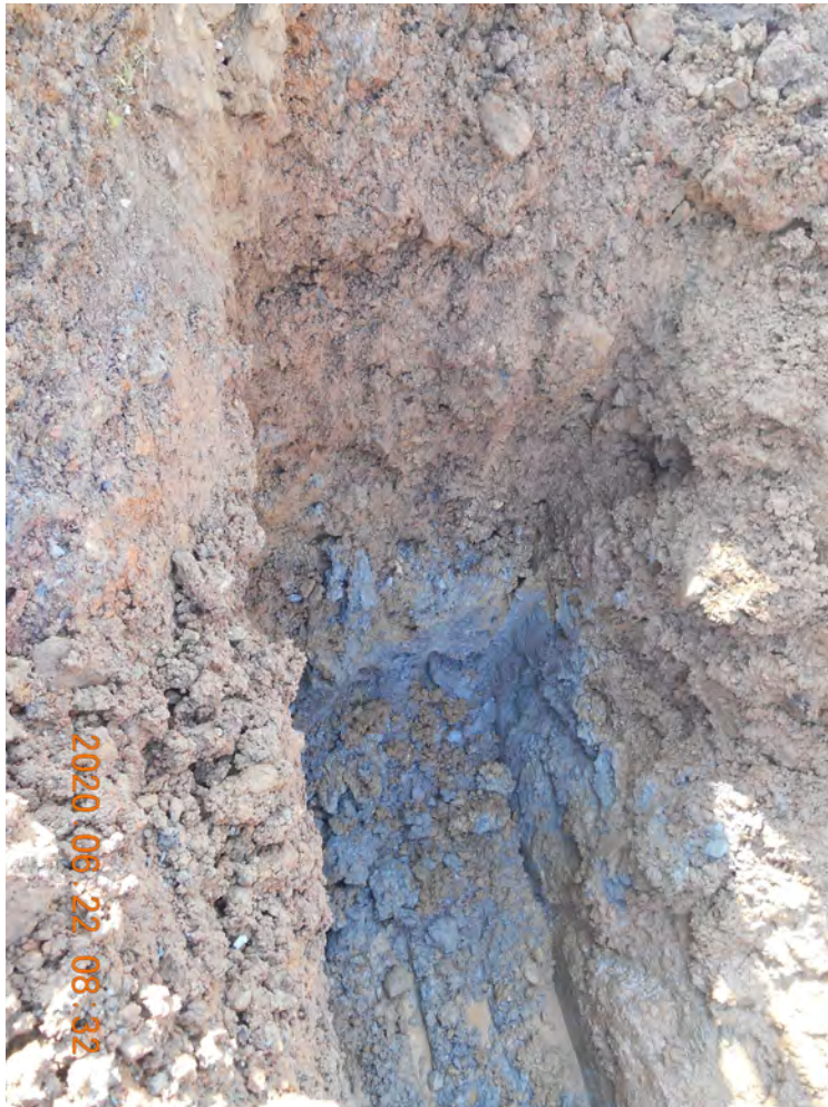
Φωτ. 11: Φρέαρ Φ1, από το βάθος των 0,00 έως 4,00 m, στα πλαίσια της Γεωτεχνικής Έρευνας - Μελέτης αποκατάστασης αστοχίας δύο επιχωμάτων στη Χ.Θ. 2+030 & 2+800 στο έργο: Παράκαμψη Νεοχωρίου.
