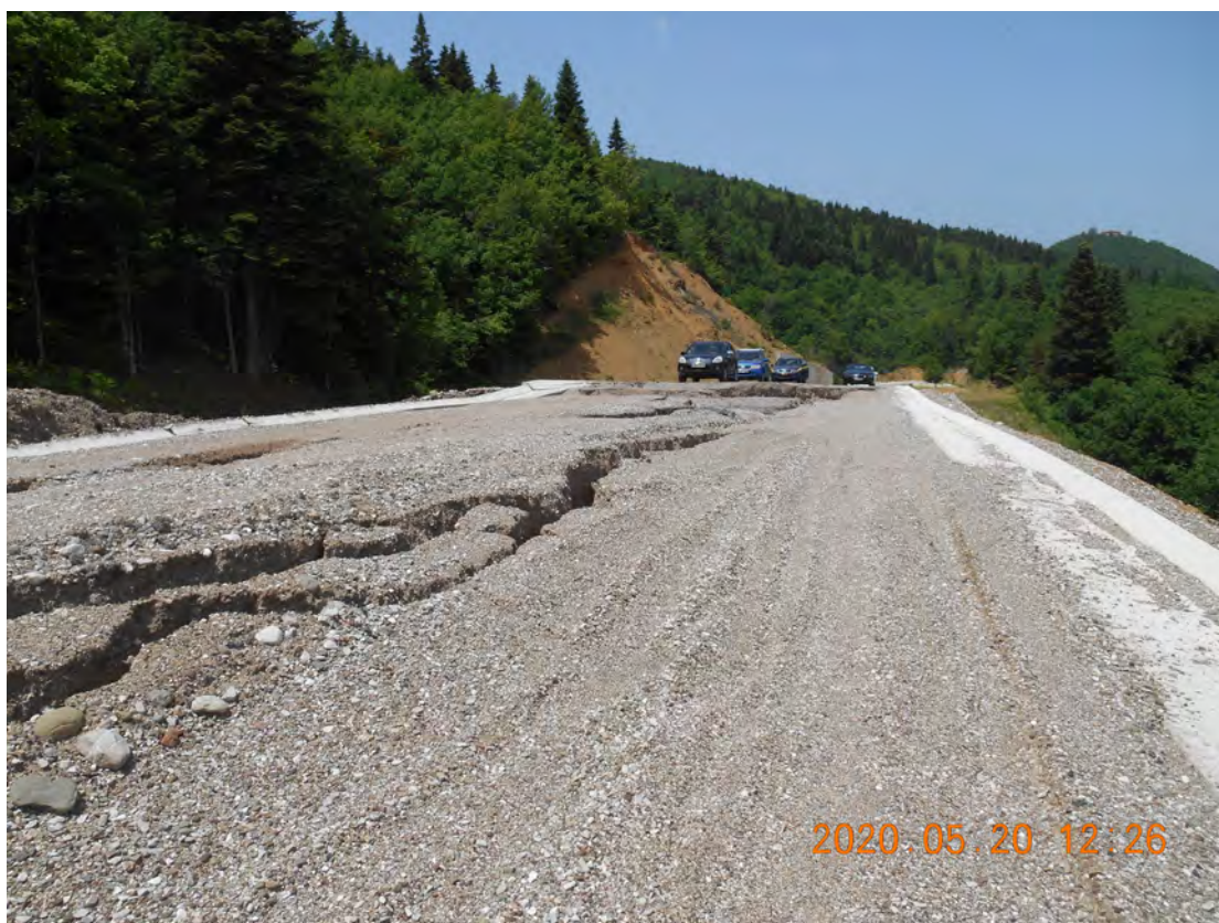
Φωτ. 24: Ανοικτές ρωγμές.
