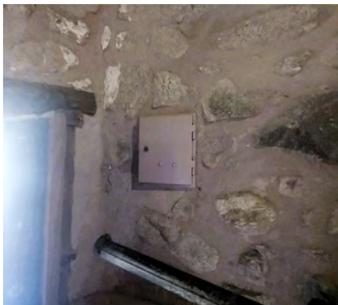
Εικ. 30 Πίνακας της ΔΕΗ και σύγχρονος μεταλλικός σωλήνας.
