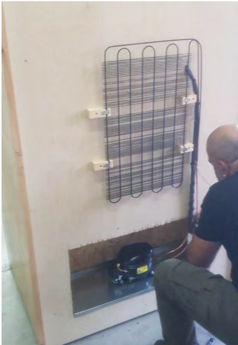
Εικ. 91 Εφαρμογή cooler και condenser στο πίσω μέρος
