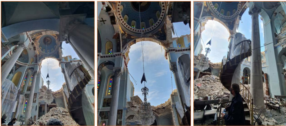
Εικόνα 8: Οι καταστροφές έπειτα από τον σεισμό στον Ιερό Ναό Κοιμήσεως της Θεοτόκου στο Καρλόβασι (Lekkas et al., 2020).
