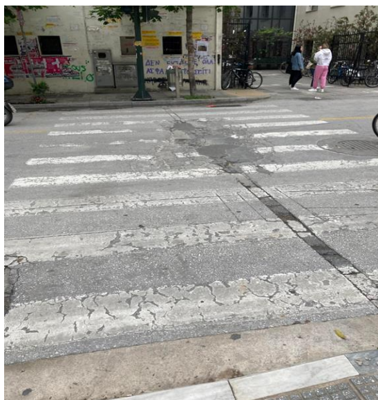
Εικόνα 20: Φθορές στην οδό Ιάσονος
