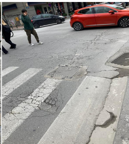
Εικόνα 21: Αλιγατορικές ρωγμές στην οδό Δημητριάδος
