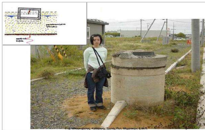
Εικόνα 7: Αστοχία θεμελίωσης φρεατίου λόγω ρευστοποίησης εδάφους - Hokkaido, Ιαπωνία (2003)
