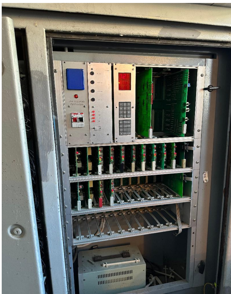
Εικόνα 2: Σύστημα ελέγχου φωτεινών σηματοδοτών
