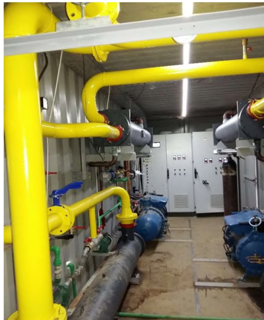
Σχήμα 6.3: Μηχανοστάσιο 1,1 MW στις καλλιέργειες σπαραγγιών της Χρυσούπολης [187]
