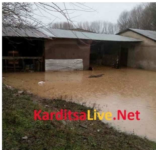
Εικόνα 11. Εκκένωση οικισμού στην Καρδίτσα κατά την κακοκαιρία «Θησέας» (Πηγή: https://www.thepressroom.gr/ ).
