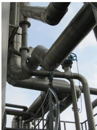
Εικόνα 28: Μονωμένες σωληνώσεις αερίου (58)
