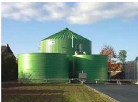
Εικόνα 19: Μια κοινή εγκατάσταση αναερόβιας χώνευσης σχεδιασμένη για την παραγωγή τόσο ηλεκτρικής όσο και θερμικής ενέργειας (56)
