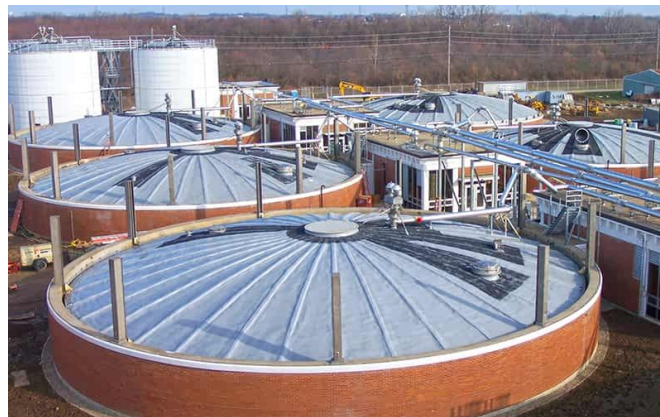
Εικόνα 32:Κάλυμμα χωνευτήρα από αεροστεγή μεμβράνη (61)
