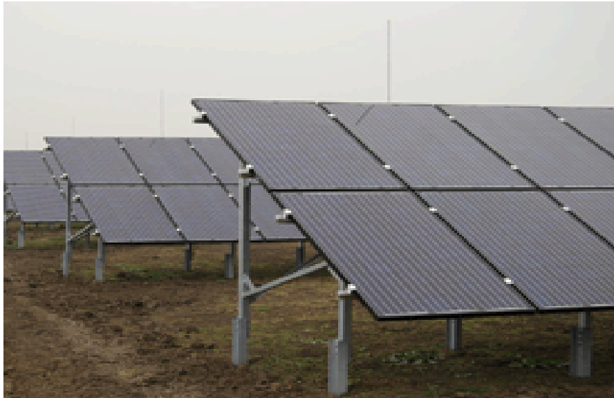
Εικόνα 6.16: Σταθερή βάση φωτοβολταϊκών
