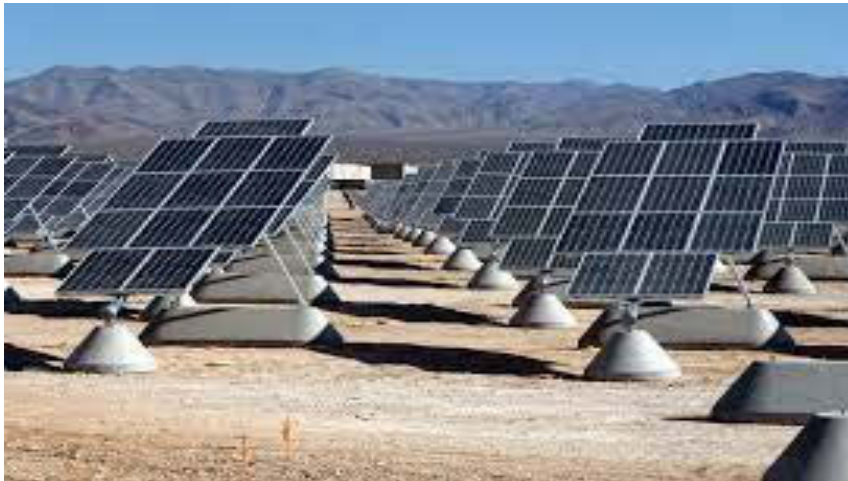
Εικόνα 6.17: Σύστημα ανίχνευσης ήλιου
