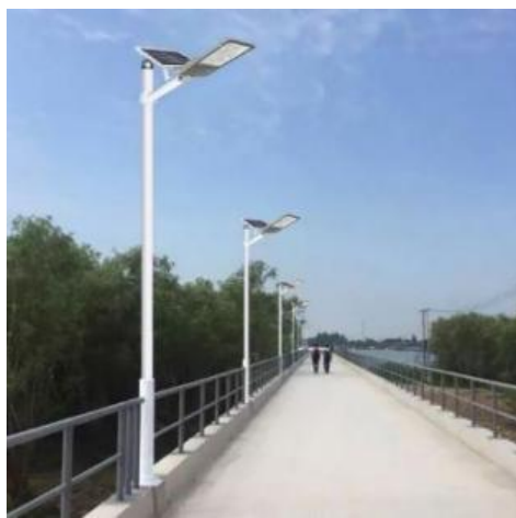
Εικόνα 79: στήλη φωτισμού με ενσωματωμένα φωτοβολταϊκά Πηγή: https://787.gr/tekhnologia-and-energeia/fotismos/iliaka-fotistika/
