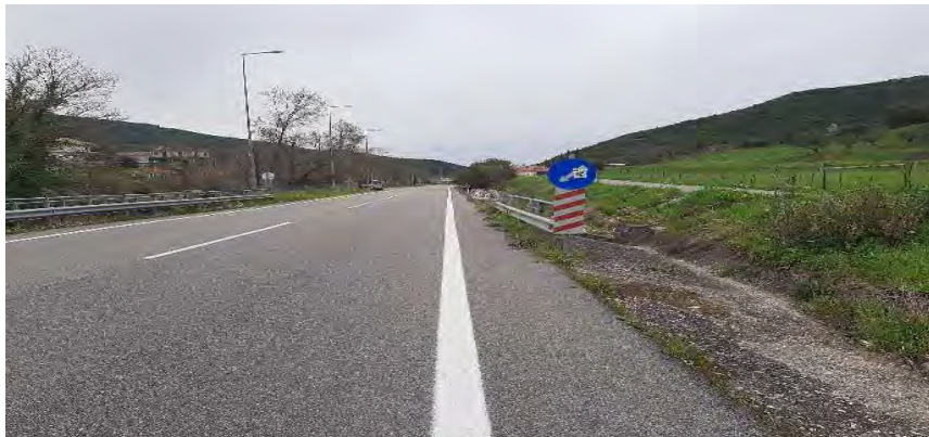
Εικόνα 7.51 Ακατάλληλο στηθαίο στο στόμιο οχέτου, χωρίς το επαρκές μήκος και απόληξη , Χ.Θ. 53+460 (πηγή: προσωπικό αρχείο)
