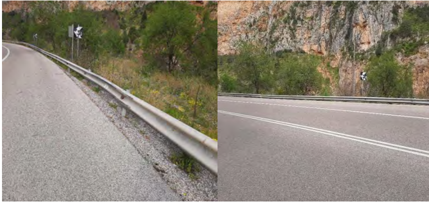
Εικόνα 7.50 Ακατάλληλο στηθαίο στην Χ.Θ. 51+500 , σε ιδιαίτερα επικίνδυνη αριστερή καμπύλη λόγω αρνητικής επίκλισης-ανεπαρκές ύψος στηθαίου (πηγή: προσωπικό αρχείο)
