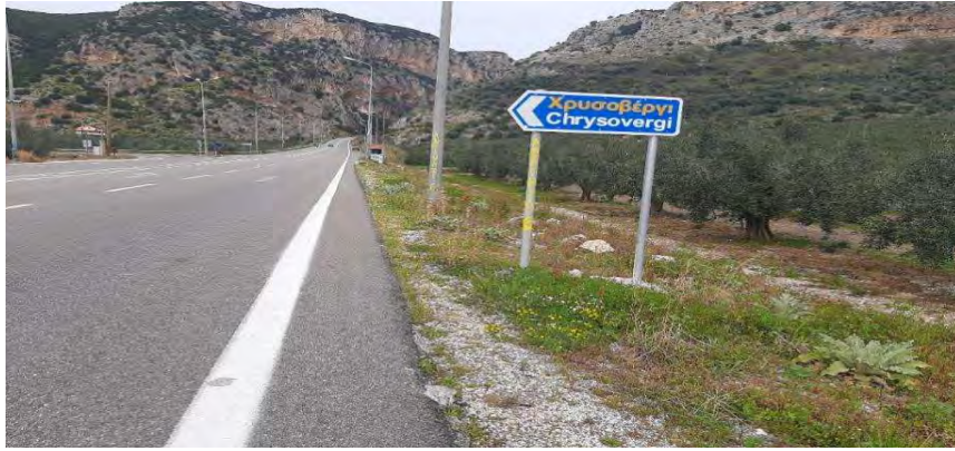
Εικόνα 7.23 Τμήμα δρόμου με μη διελεύσιμα πρανή και χωρίς τοποθέτηση στηθαίου Χ.Θ. 49+470 Κατεύθυνση προς Γέφυρα Ερμίτσα (Πηγή: Προσωπικό αρχείο)
