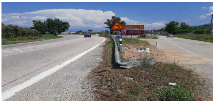
Εικόνα 7.52 : Έλλειψη ΣΑΕΠ - Κόμβος Μακρυνείας Κατεύθυνση προς Γέφυρα Ερμίτσας Χ.Θ. 58+000 (πηγή: προσωπικό αρχείο)
