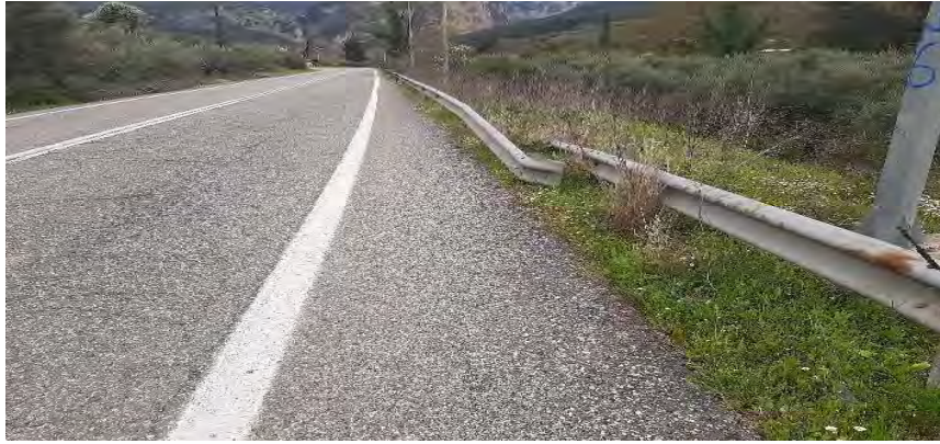
Εικόνα 7.56 Ακατάλληλη σύνδεση στηθαίου Χ.Θ. 54+135 Κατεύθυνση προς Χαλίκι (Πηγή: Προσωπικό αρχείο)
