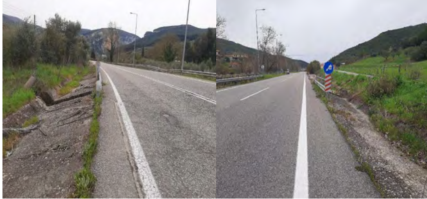
Εικόνα 7.25 Ανοιχτές τάφροι με τοποθέτηση στηθαίου χωρίς το κατάλληλο μήκος και απολήξεις, στο στόμιο οχετού Χ.Θ. 54+118 και Χ.Θ. 53+460 (Πηγή: Προσωπικό αρχείο)
