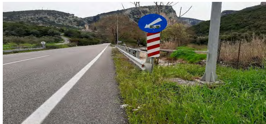
Εικόνα 7.55 Μη επαρκές μήκος, έλλειψη απόληξης και ανασφάλιστο εμπόδιο-στύλος οδοφωτισμού Χ.Θ. 53+400 (Πηγή: Προσωπικό αρχείο)
