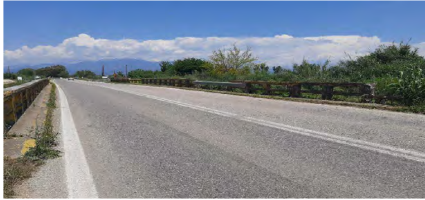
Εικόνα 7.53 Ακατάλληλο στηθαίο από σκυρόδεμα σε γέφυρα Χ.Θ. 59+620 (Πηγή: Προσωπικό αρχείο)
