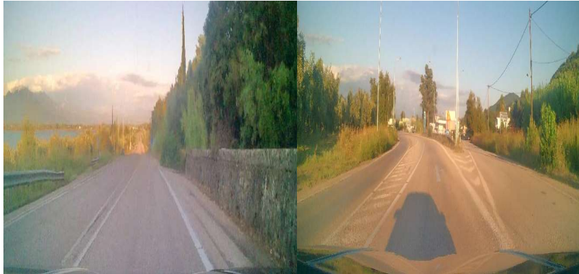
Εικόνα 7.59 Ενδεικτικές φωτογραφίες με τμήμα οδού με φθαρμένο οδόστρωμα Χ.Θ. 56+500 και Χ.Θ. 58+200
