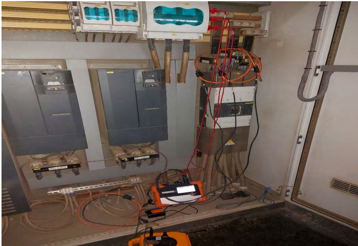
Εικόνα 91: Σύνδεση μετρητικού οργάνου στον πίνακα φούρνου τούθλου.
