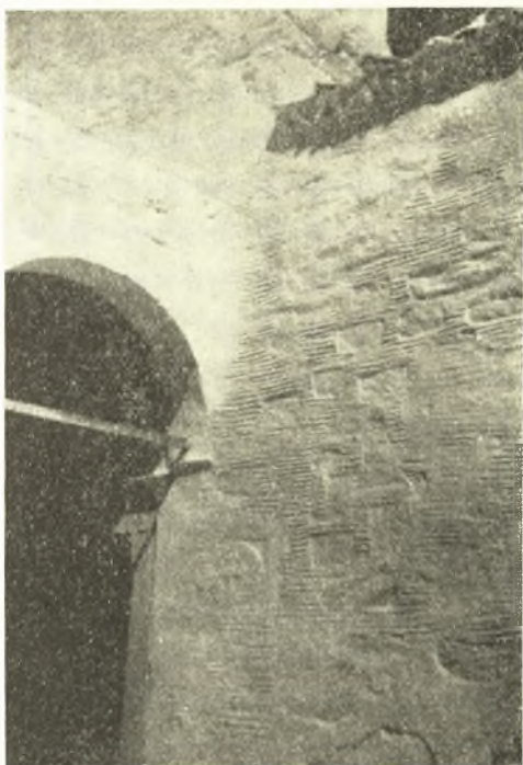
Εἰκ. 8. Ὁ δυτικὸς τοῖχος τοῦ ναοῦ ὑπὸ τὸ αἰγαιοπελαγικὸν ἔνδυμα ἐπιχρίσεως καὶ ἀσβεστοχρίσεως.
