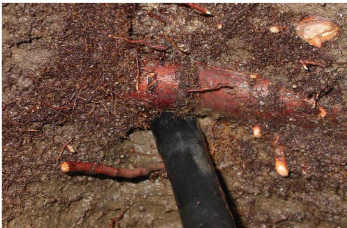
Φωτογραφία 5.2: Συμπύεση πλαστικού σωλήνα υπόγεια στάγδην άρδευσης από ρίζες ροδακινιάς στην Καλιφόρνια των Η.Π.Α. Φωτογραφία T. Trout, USDA-ARS - Καλιφόρνια.
