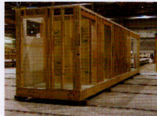
ΕΙΚ.201-3_ Προετοιμασία τόπου εγκατ., κατασκευή τυποποιημένων κομματιών στο εργοστάσιο και συναρμολόγηση (πηγή: βιβλίο "Prefab Green", των Michelle Kaufmann/ Catherine Remick, Σελ.66)
