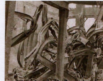
εικ.157_ Δοκοί χάλυβα μετά από αυξημένη θερμοκρασία λόγω πυρκαγιάς, (πηγή: http://www.oregontruss.com/truss-info/applications/wood-vs-steel )
