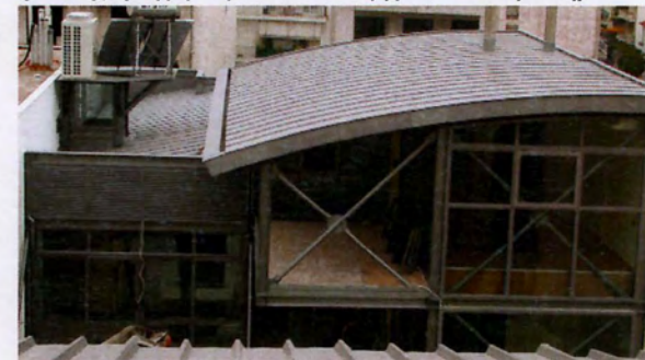
εικ.240_ στέγη τιτανιούχου ψευδάργυρου μεταλλικού κτιρίου της εταιρίας "Planning" στον Βόλο, (2011), (πηγή: προσωπικό αρχείο Κ.Αδαμάκη)
