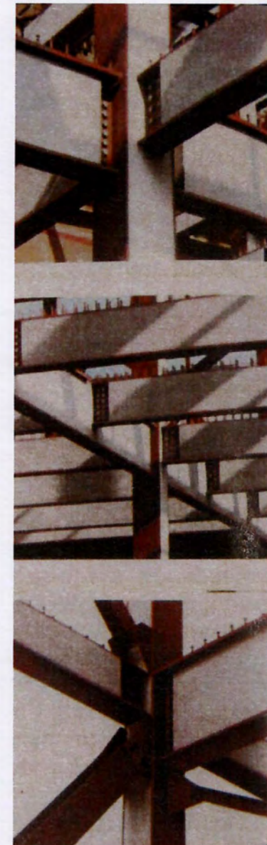
εικ.156_ Πλήρωση με σκυρόδεμα διατομών διπλού T, (πηγή: περιοδικό "Κτίριο", Έκδοση: Μεταλλικά κτίρια,2006)
