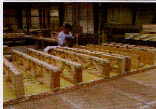
ΕΙΚ.181,182_Η προκατ.κατοικία κατασκευάζεται στο εργοστάσιο σε ελεγχόμενο περιβάλλον, (πηγή: βιβλίο Prefab Green, των Michelle Kaufmann/ Catherine Remick, Σελ. 66-68)
