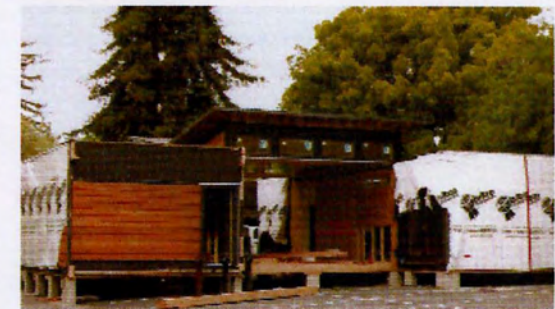
ΕΙΚ.185(πάνω)_Γερανός τοποθετεί τα κομμάτια στον τόπο εγκατ., ΕΙΚ.186 (κάτω)_Στον τόπο εγκατάστασης βιδώνεται και συναρμολογείται, (πηγή: βιβλίο Prefab Green, των Michelle Kaufmann/ Catherine Remick,Σελ.69)
