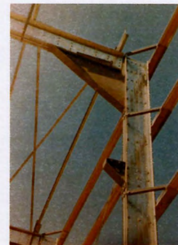
ΕΙΚ.293 Εφαρμογή Συνδεσμολογία διατομής "ΚΒ", (πηγή: Κατάλογος προϊόντων της KONTI Steel Hellas)
