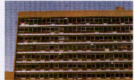
εικ.168-169_Θερμοφωτογραφική απεικόνιση πολυώροφου κτιρίου. Όσο πιο κοντά στο κόκκινο χρώμα- υψηλότερη θερμοκρασία και άρα μεγαλύτερες θερμικές απώλειες (πηγή: Κτίριο, (νοέμβριος 2009, τεύχος 10, σελ.122)
